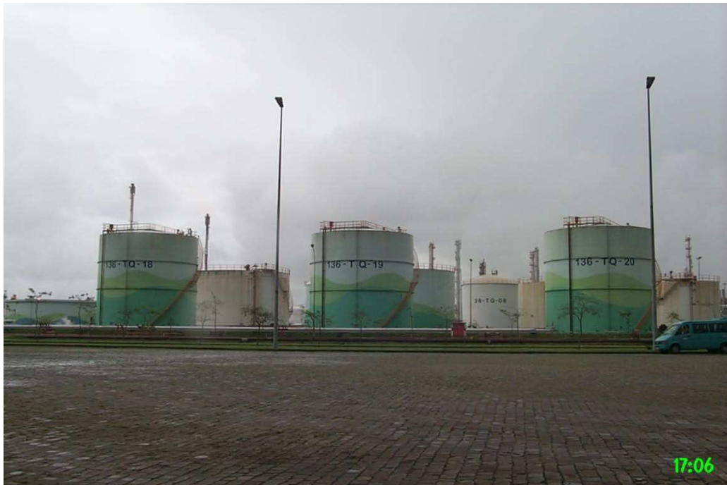
Tanques de teto flutuante com selo de nitrogênio e medidores eletrônicos de nível
