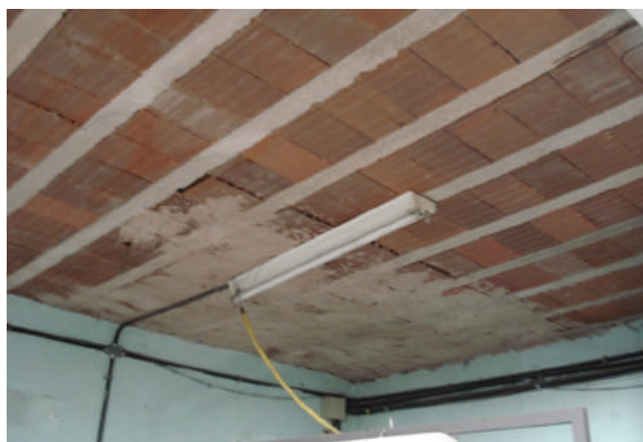
Acidentário: Conexões expostas Arquitetural: Local não acabado
