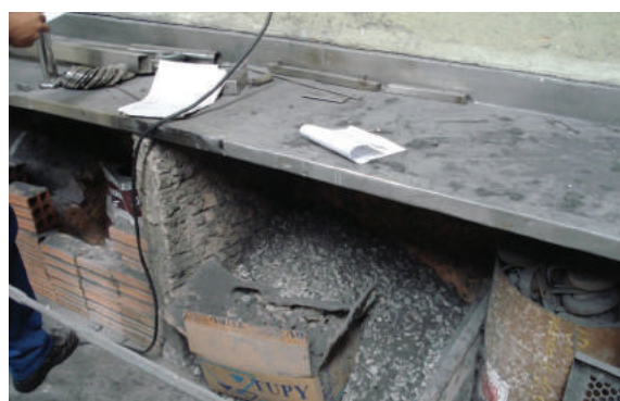
Químico-ambiental: Resíduos químicos acumulados Biológico: Sujeira acumulada Arquitetural: Falta de local definido para estoque e guarda de materiais
